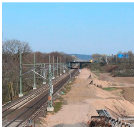
Bevor das eigentliche dritte Gleis verlegt werden kann, sind umfangreiche Erdarbeiten erforderlich.
