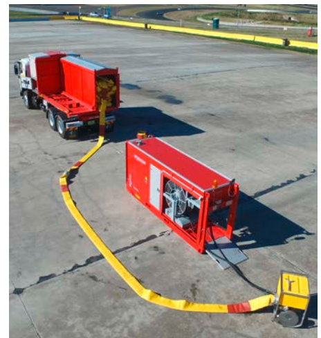
Pumpeinheit mit Tauchpumpe und zwei Kilometer langem Schlauch.
