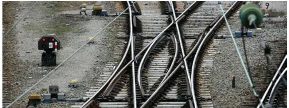
Weichen und Signale werden dank modernster Leit- und Sicherungstechnik elektronisch gestellt.
